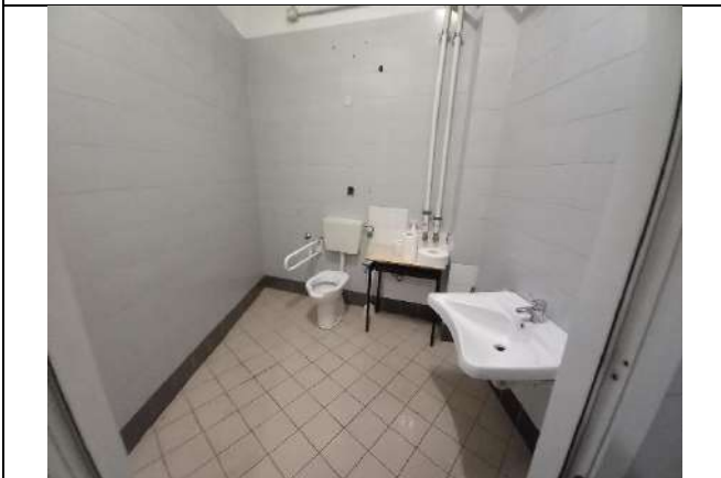
SERVIZIO IGIENICO AL PIANO TERRA – ausili insufficienti
