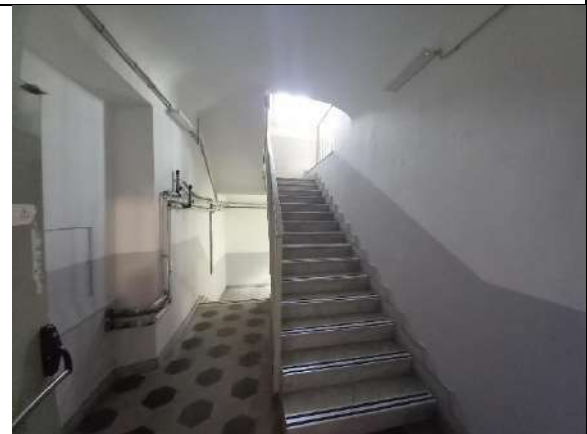
SCALE AL PRIMO PIANO – non conforme
